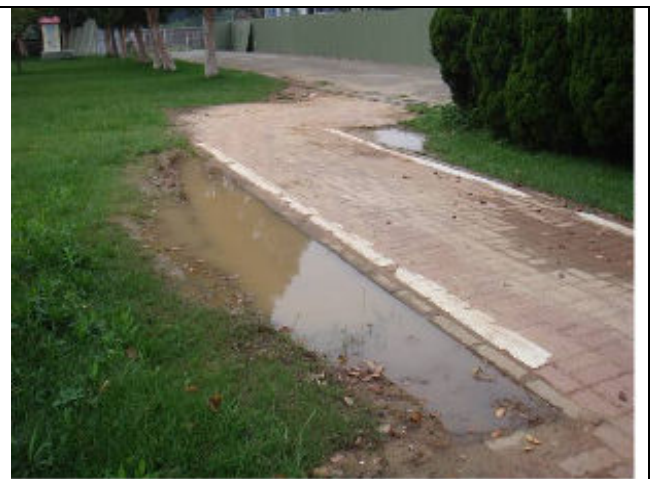
水池周圍積水
